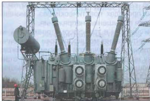
Рис. 162. Современный трансформатор большой мощности
